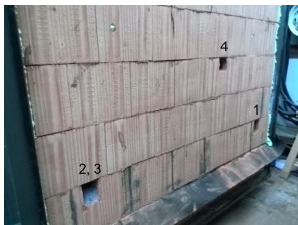
Fig. 13: plekken waar proefstukken zijn genomen
